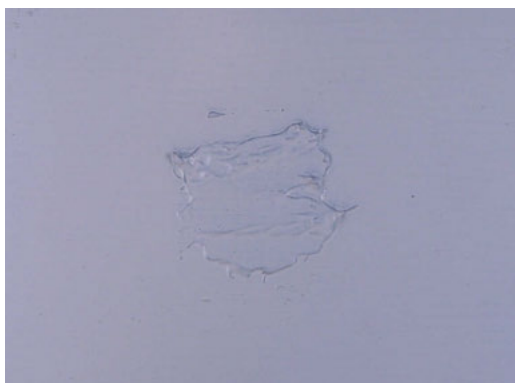
Figura 21: Grasa lubricante recubierta de pintura (ningún defecto por LABS)
